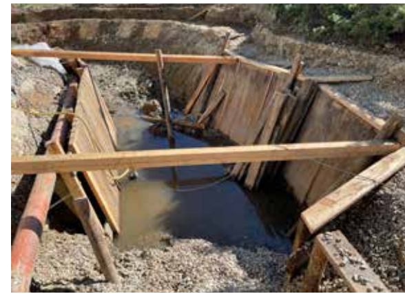
Auch kleine Rückschläge durch Starkregen, der über Nacht eine ganze Seitenwand zum Einsturz brachte, konnten das Team nicht aufhalten. Even minor setbacks like heavy rain, after which an entire sidewall collapsed overnight, could not stop the team.
