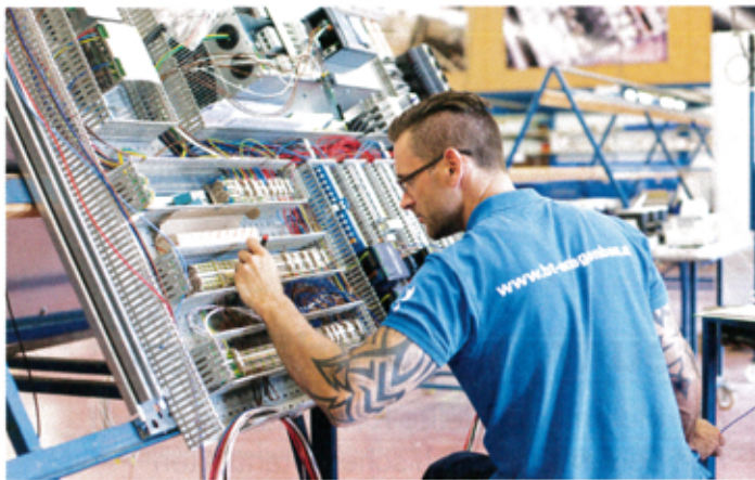
Rund 300 Einzelkomponenten von Rittal mussten in nur wenigen Wochen für das Stahlwerk in Südkorea vorbereitet werden.
