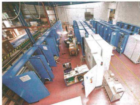
In einem eigens für den Kunden definierten Blauton erstrahlen die Schaltschränke im koreanischen Stahlwerk.
